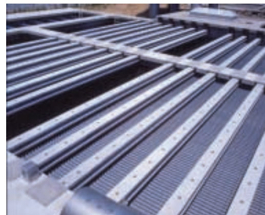
写真1 浄水場傾斜板
