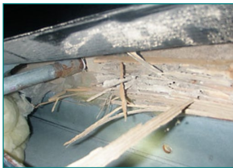
鉄骨住宅・床下の被害
