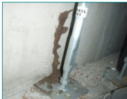
土間コンクリートでの蟻道
