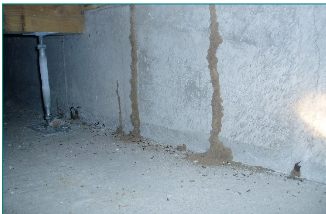
ベタ基礎も貫通して侵入するシロアリ
