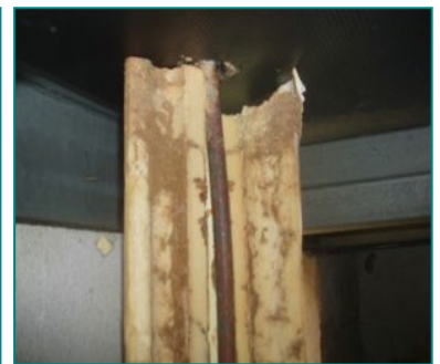
軽量鉄骨・被覆配管の被害
