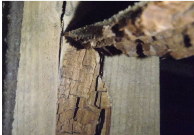
腐朽による甚大な被害 (出典：(株)テオリアハウスクリニック)
