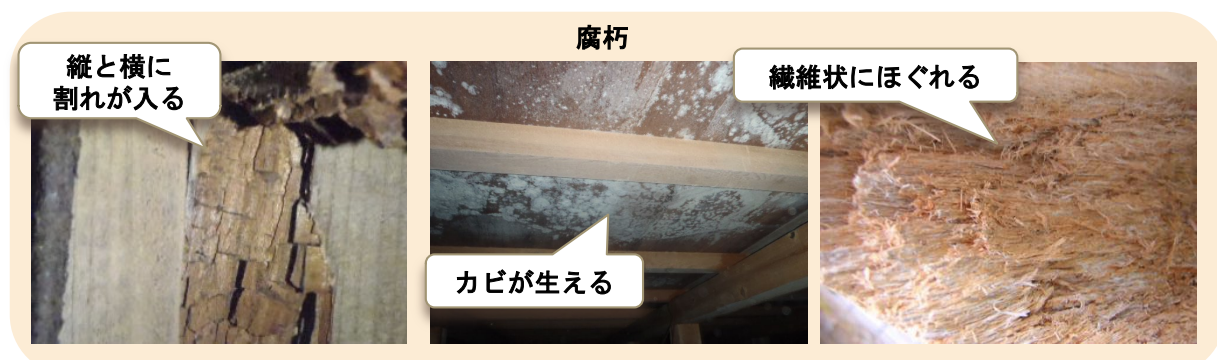
シロアリ被害と腐朽の見分け方 (出典：(株)テオリアハウスクリニック)
