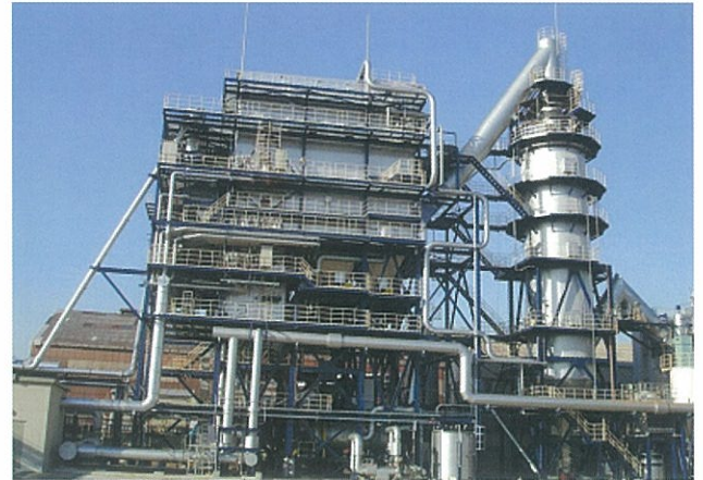
図6.エコシステム岡山・TR処理施設
