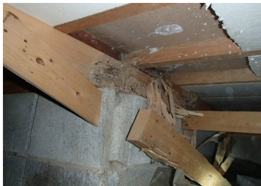
玄関の被害もここまでになると床下からも判断できる (出典: (株)テオリアハウスクリニック)
