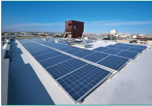
太陽光発電設備専用の防水基礎
