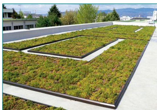
塩ビ樹脂系シート防水に設置された トレイ式薄層緑化
