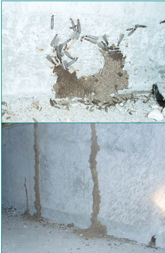
ベタ基礎を貫通した蟻道から出る羽アリと兵アリ
